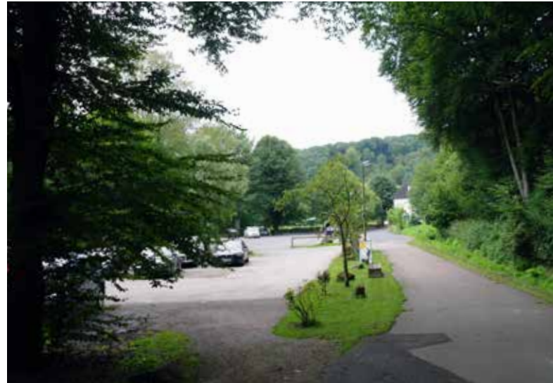
Anbindungen zu den Stellplätzen stellenweise im schlechten Zustand
