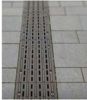
Barrierefrei ausgestaltete Entwässerungsrinne im Blindenleitsystem der Stadt Bergisch Gladbach (Quelle: Stadt Bergisch Gladbach)
